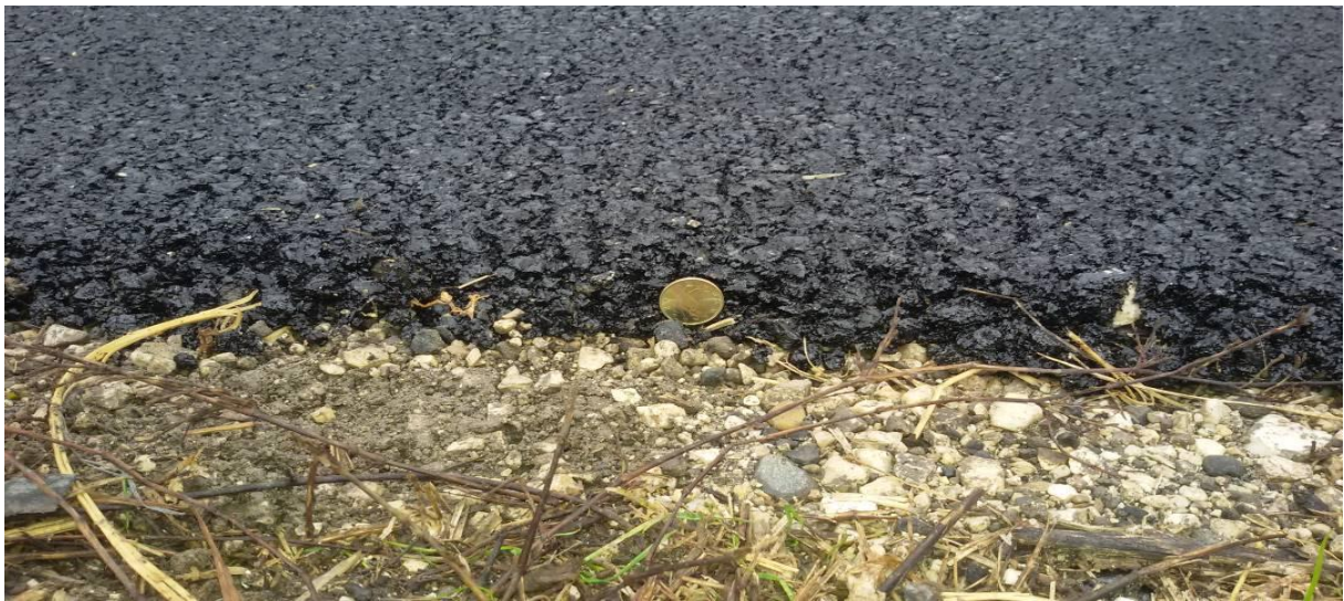
Erodált repedezett szélek kb egy héttel az aszfaltozás után!
