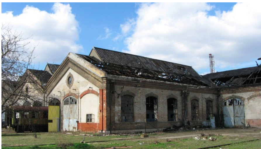
7. ábra Az Istvántelki Főműhely egy leromlott épülete
